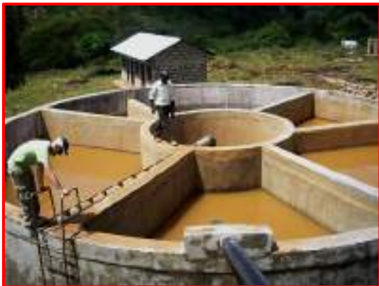
^ LA VASCA DI DECANTAZIONE
